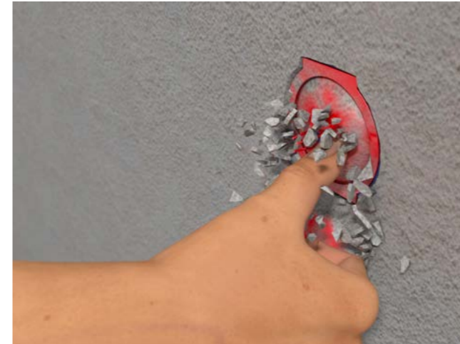
Putzdeckel kann mit der Hand eingedrückt werden...
