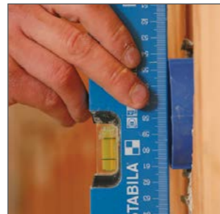
... so dass es ca. 1 cm aus dem Mauerwerk steht.
