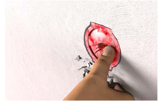
Putzdeckel kann mit der Hand eingedrückt werden ...
